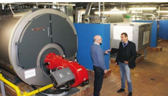
Fotos: lh Blick in den unterirdischen Kesselraum mit vier Kesseln
