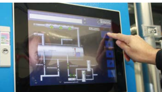
Komplexe Steuerungs- und Leittechnik regelt die Prozesse
